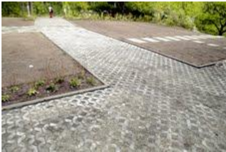
KUVA 16. Yksityispiha, reikälaatta, reiät nurmettuvat ja sammaloituvat.
